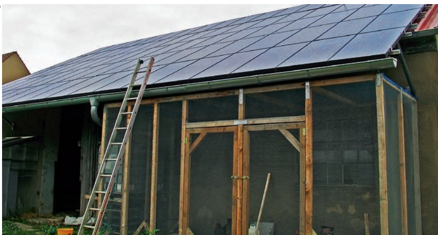
Wer Module so installiert, darf sich nicht wundern, wenn er für Schäden aufkommen muss.
